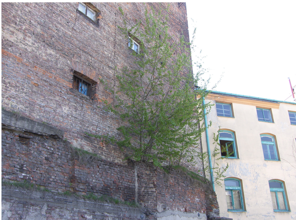
Fot. 4 Roślinność porastająca ściany budynków.
